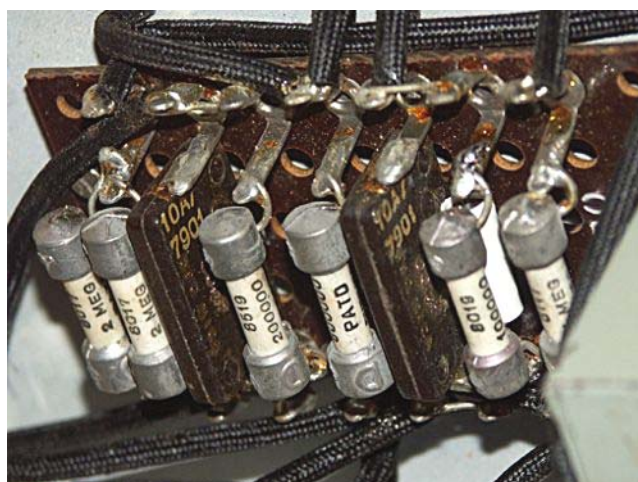
Motståndsplint med reparation
