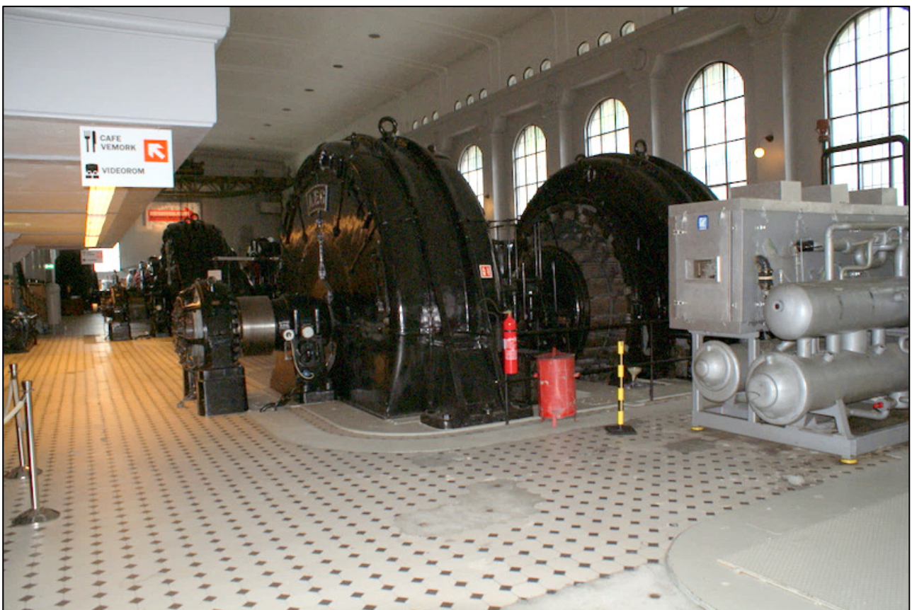
Et glimt inn i generatorhallen med gamle AEG generatorer.
