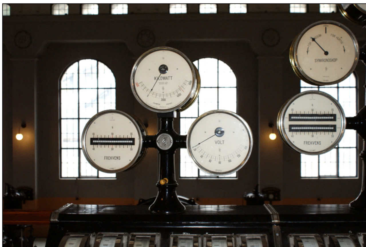
Disse instrumentene sto over kontrollpulten, dette var laget av Siemens & Halske. Det er et imponerende syn å skue utover alle generatorene i hallen.
